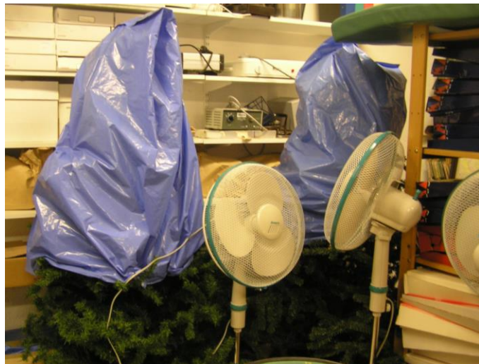
Bild från en arkivlokal som också använts som förråd för julpynt och fläktar, detta är inte tillåtet.
